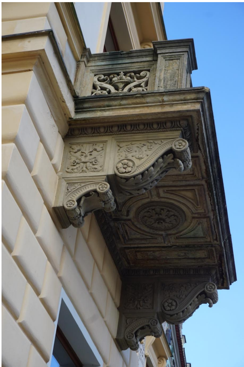
Detail poškození rom-cem a pískovcových prvků balkonů.
