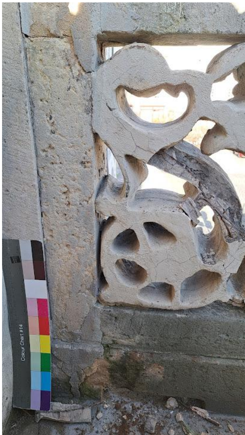
Detail poškození rom-cem a pískovcových prvků balkonů. Rozpadající se kovová armatura rom – cem výplní (kufstein).
