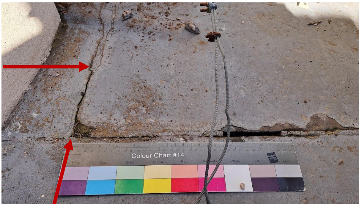
Detail poškození pískovcové desky balkónu. Příčná trhlina nad kovovou traverzou.
