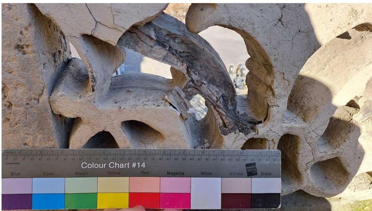
Detail poškození rom-cem a pískovcových prvků balkonů. Rozpadající se kovová armatura rom – cem výplní (kufstein).
