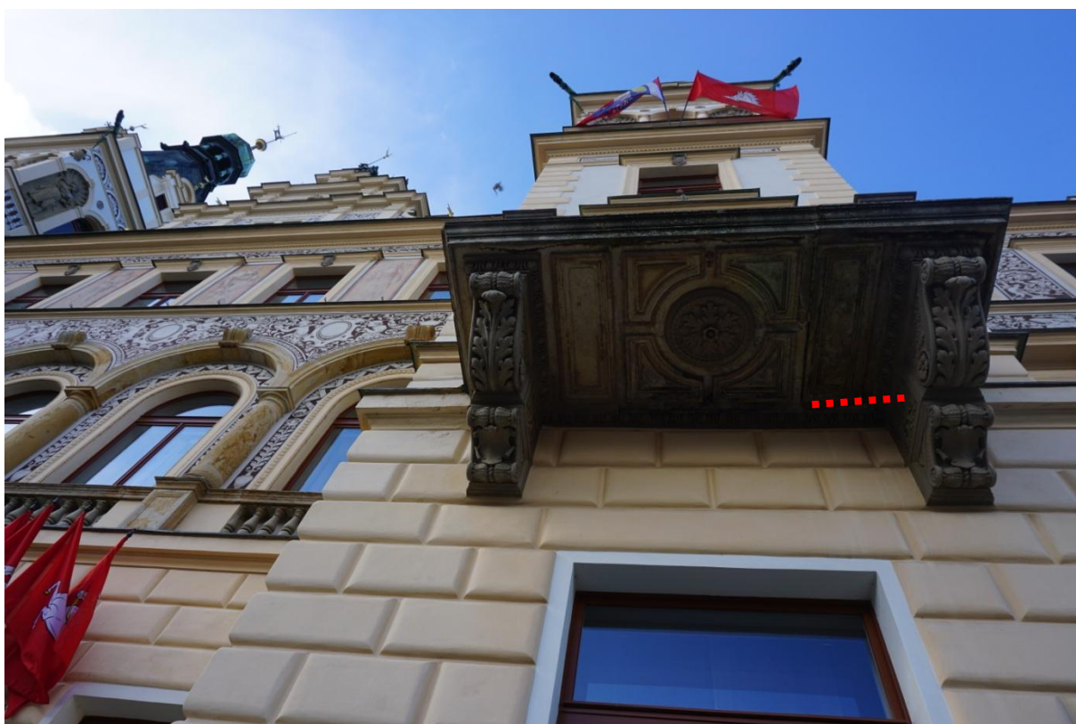
Detail poškození pískovcové desky balkónu.
