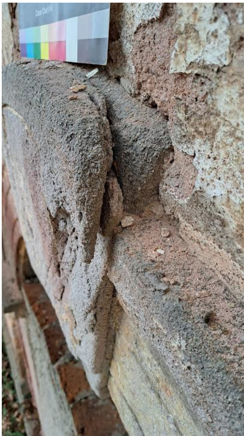
Jižní fasáda. Pískovcový vstupní portál. Detail zvětralého pískovce- klenáku a navazujících omítek. Havarijní stav!
